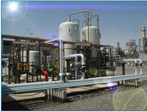
Ionenaustauscher im Petrochemie-Komplex
